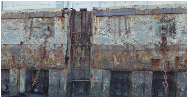
Figura 5. Escala de hierro embebida. Puede apreciarse el grado de oxidación
